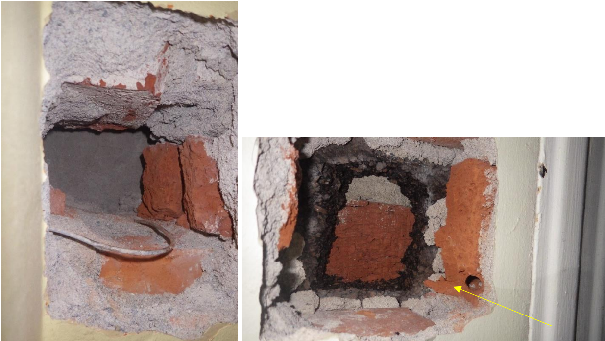
Kuvat 25 a ja b. a) Rakenneavauksessa RA-US1 tehtiin lastentalon länsipäätyyn patterisyvennyksen kohdalle. Avauksen perusteella ko. kohdassa ei ole korkkia. b) Rakenneavauksessa RA-US4 asuntosiiven länsisivustalla patterisyvennyksen kohdalla on käytetty 20 mm paksuista korkkieristettä.
