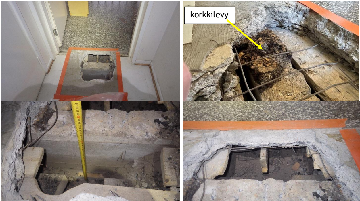
Kuvat 31 a-d. Rakenneavaus RA-VP5 alalaattapalkistoon. Rappukäytävän osuus on mosaiikkipinnalla (jonka pintarakennetta ei tutkimuksessa rikottu/ avattu) ja avaus tehtiin tämän takia mosaiikkilaattaosuuden rajakohtaan. b) Palkin päällä korkkieriste noin 30 mm. c) Palkiston reunoilla ja pintalaatan alla muottilautoja. d) Erilliset puukannattimet pintalaatan muottilautoitukselle.
