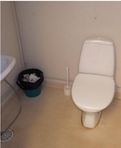
Kuva 45. Yleiskuva asunosiiven kellarikerroksen pukuhuoneen wc-tila (tila 034). Lattiassa todettiin paikoin jonkin verran poikkeavia pintakosteusilmaisimen lukemia.
