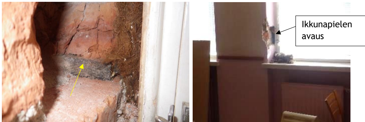
Kuvat 26 a ja b. a) Rakenneavaus RA-US2 ulkoseinän ja ikkunan liittymäkohtaan. Ikkuna on naulattu tervattuun puutiileen, jossa todettiin vahva kreosootin haju. Ikkunan tilkkeenä on käytetty mm. pellavarivettä, jossa todettiin myös vahva kreosootin haju. b) Yleiskuva ikkunaliittymistä ja patterisvyennyksistä.
