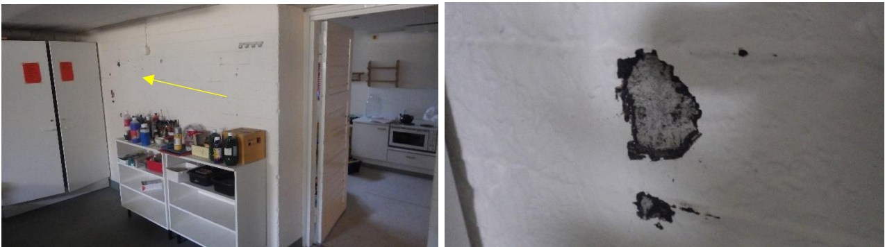
Kuvat 17 a ja b. Tilassa 006 kantavan väliseinän maalipinta on paikoin lohkeillut ja irronnut alustastaan. Maalipinnan alla on pikisively.
