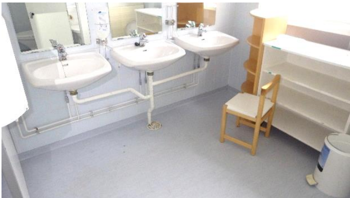
Kuva 57. Yleiskuva päiväkodin käytössä olleesta wc-tilasta (tila 217). Ei poikkeavia pintakosteusilmaisimen lukemia lattiassa tai seinissä.
