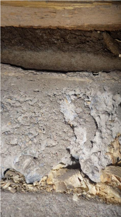
Kuva 41. a) Rakenneavaus RA-YP5 tehtiin yläpohjan palkkilinjan viereen. Palkin on erillinen puukuitulevykaista. Puukuitulevy haasi vahvasti kreosootille ja PAH(16) -summapitoisuudeksi määritettiin laboratoriossa 25000 mg/kg.
