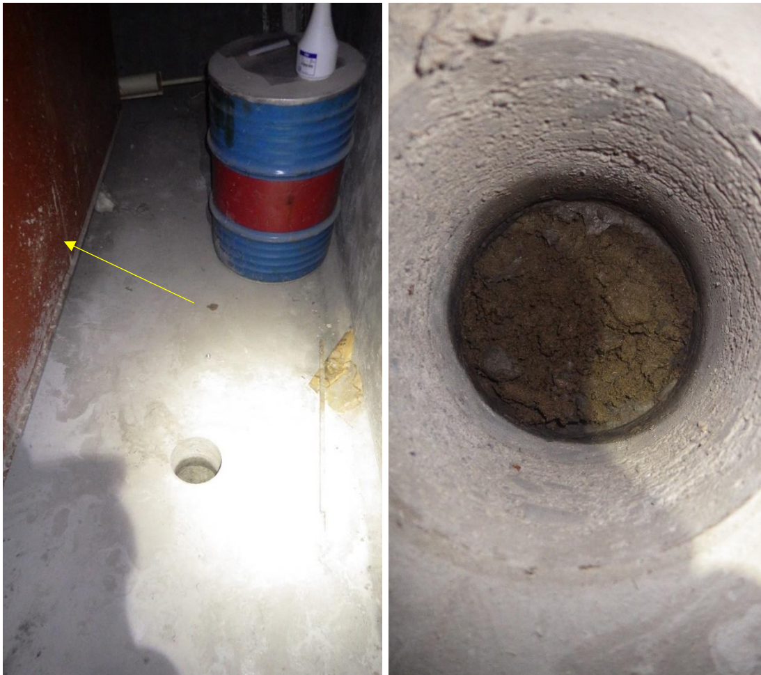
Kuvat 22 a ja b. a) Öljysäiliön (keltainen nuoli) viereen tehty rakenneavaus RA-AP3 tilassa 023. Kulku tilaan oli seinässä olevan luukun kautta. b) Alalaatan kokonaispaksuus on noin 150 mm, jonka välissä pikikerros ja alla hiekkakerros. Avauskohdan pintalaatasta ja maaineksesta otettiin myös öljyhiilivetynäytteet.
