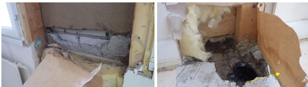
Kuvat 27 a ja b. a) Rakenneavaus RA-US5a. Vanha betoninen parvekekaide on jätetty seinärakenteen sisälle. Seinärakenteen mineraalivillassa ja puukuitulevyssä on laboratorioanalyysin perusteella mikrobikasvustoa. Sisäpinnan paperissa on kuivuneita kosteusjälkiä. b) Rakenneavaus RA-US5b. Sisäverhouksen takana olevassa paperissa kosteusjälkiä seinän ja välipohjan liittymäkohdassa.
